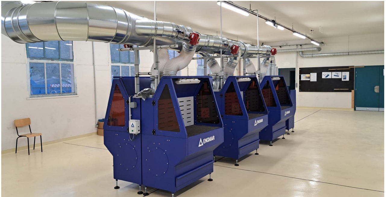
Réseau basse dépression avec tables aspirantes.
